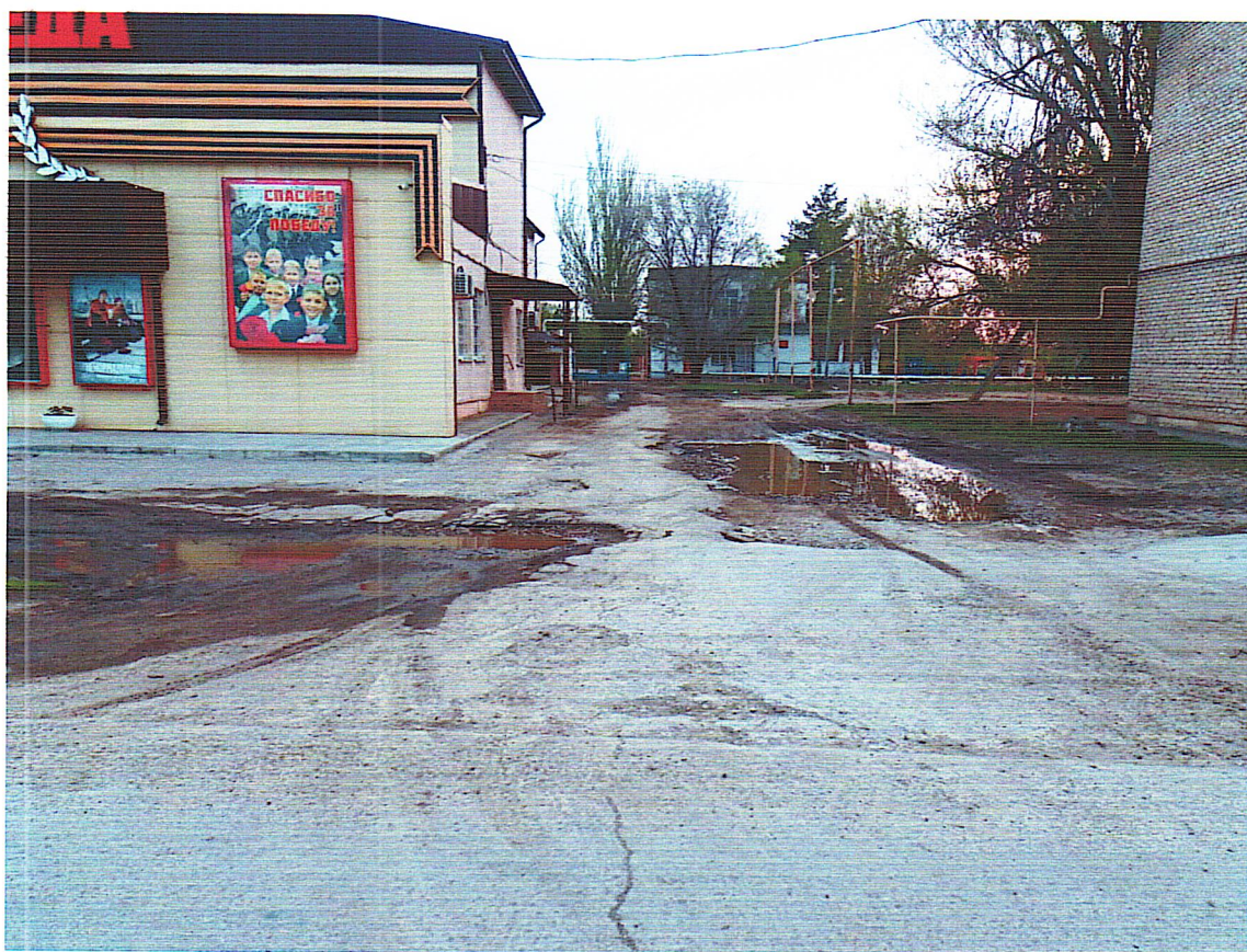
Фото 1, 2 – участок дорожного покрытия перед к/т «Победа» на 16.04.2024 г.
