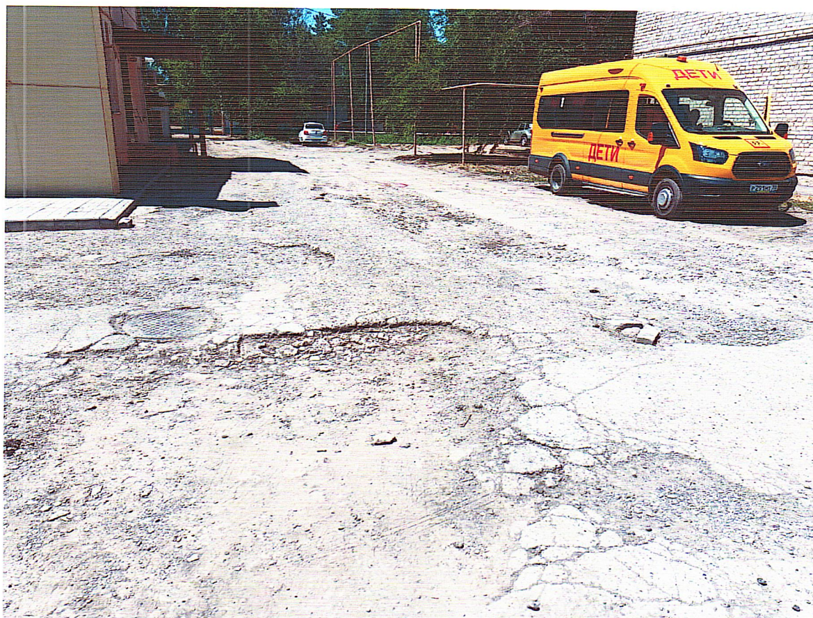
Фото 3, 4 - участок дорожного покрытия перед к/т «Победа» на 19.06.2024 г.
